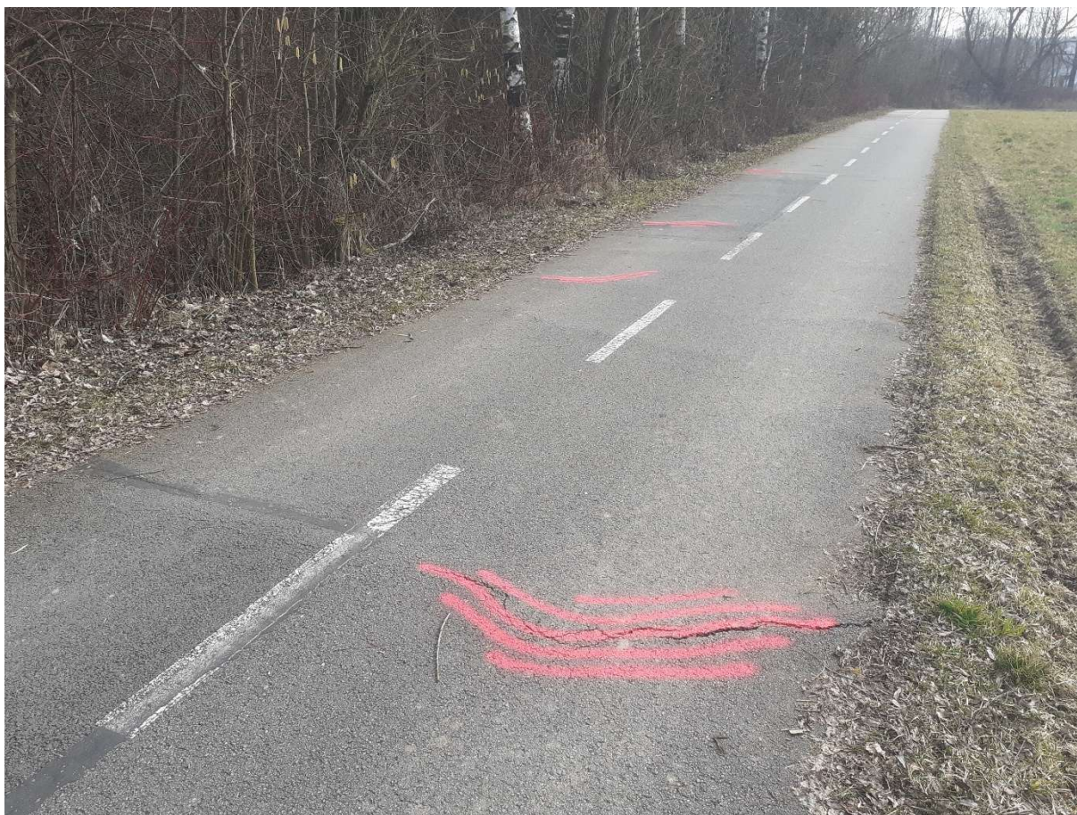
Foto: Poškozená vozovka na cyklostezce Ústí nad Orlicí - Letohrad
